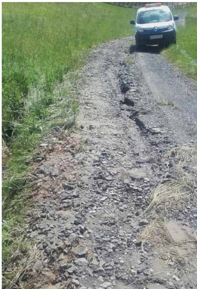
Immer wieder Unwetterschäden wie z.B. in Lembach
