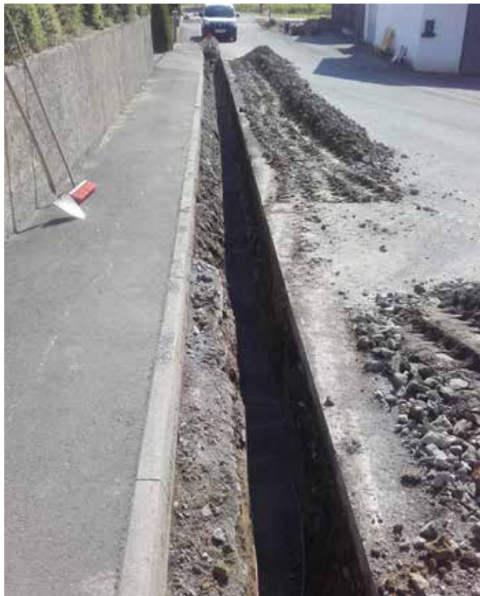
Ortsbeleuchtung Instandhaltung Schweinz
