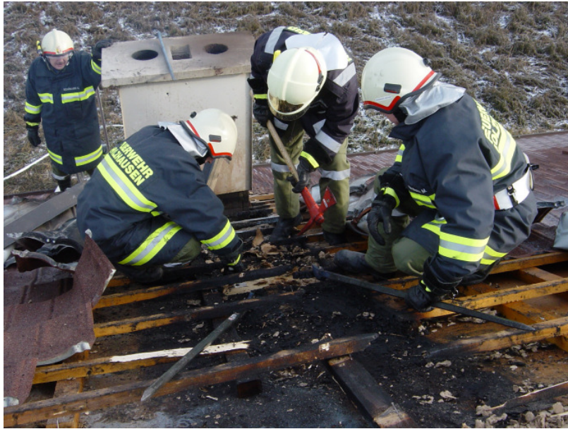
Nachlöscharbeiten nach Dachstuhlbrand
